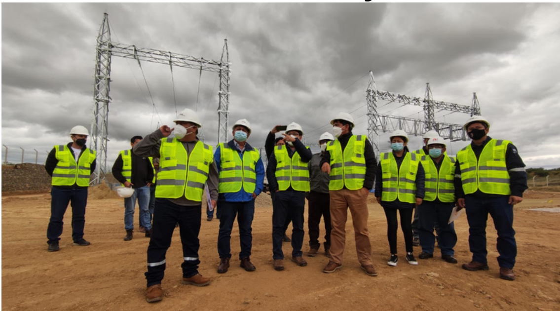
Ministro de Hidrocarburos y Energías, Franklin Molina encabeza inspección técnica a la Subestación La Angostura - Tarija
